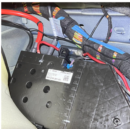
Strøm hentes fra sikringsboks.
